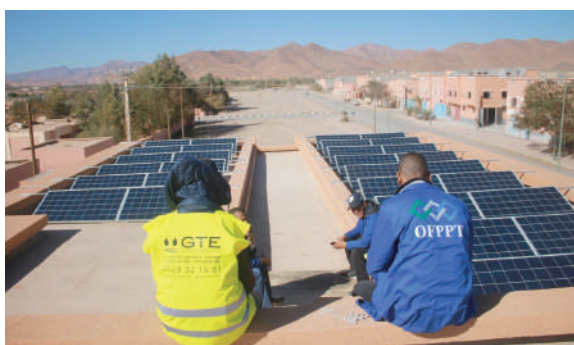
À gauche : Installation photovoltaïque pour l'association Al Amal, Tata - À droite : Installation chauffage à air solaire pour l'école primaire Ougrivan Ben Mohammed, Tounfite
