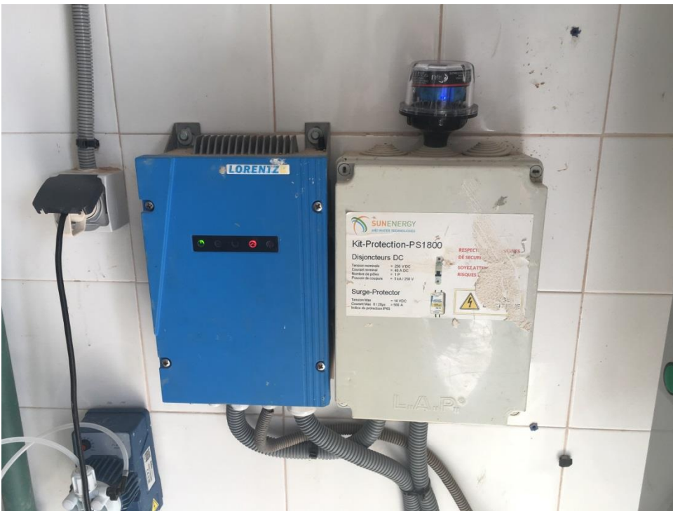
Photo 2: maison d'eau avec onduleur LORENTZ et kit de protection avec parafoudre
